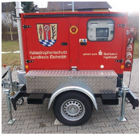
Stromerzeuger: Standort Feuerwehr Hepberg.
