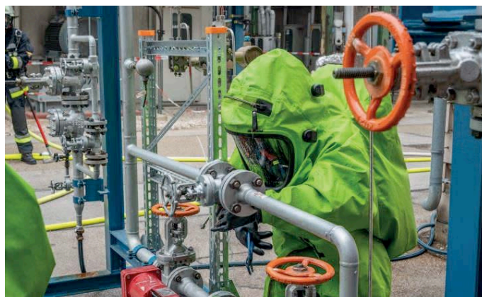
Auffangen von Lauge und Abdichten der Schraubverbindung unter Einsatz von Chemikalienschutzanzügen.
